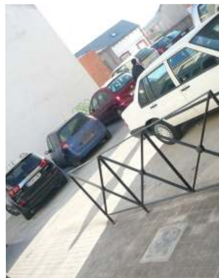
Pavimentación del aparcamiento junto a la Escuela de Música, un espacio muy utilizado para estacionar en el centro histórico que además ha sido delimitado con vayas para evitar que los vehículos aparquen encima de la acera.
